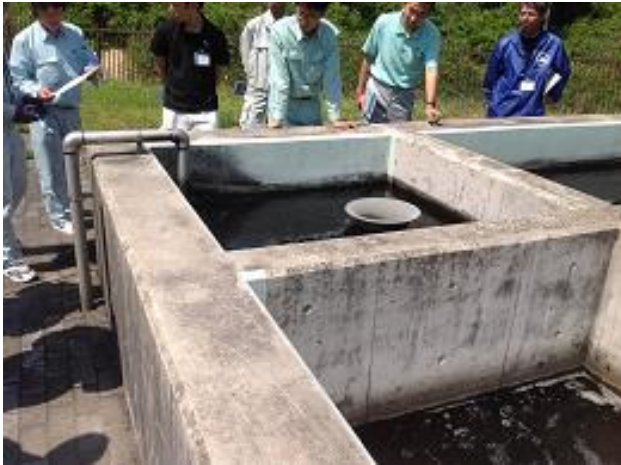
浄水場施設見学：左側の管から、活性炭が注ぎ込まれています。
